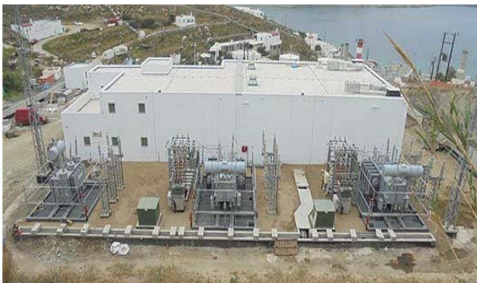
Νέος υποσταθμός ηλεκτροδότησης Μυκόνου
