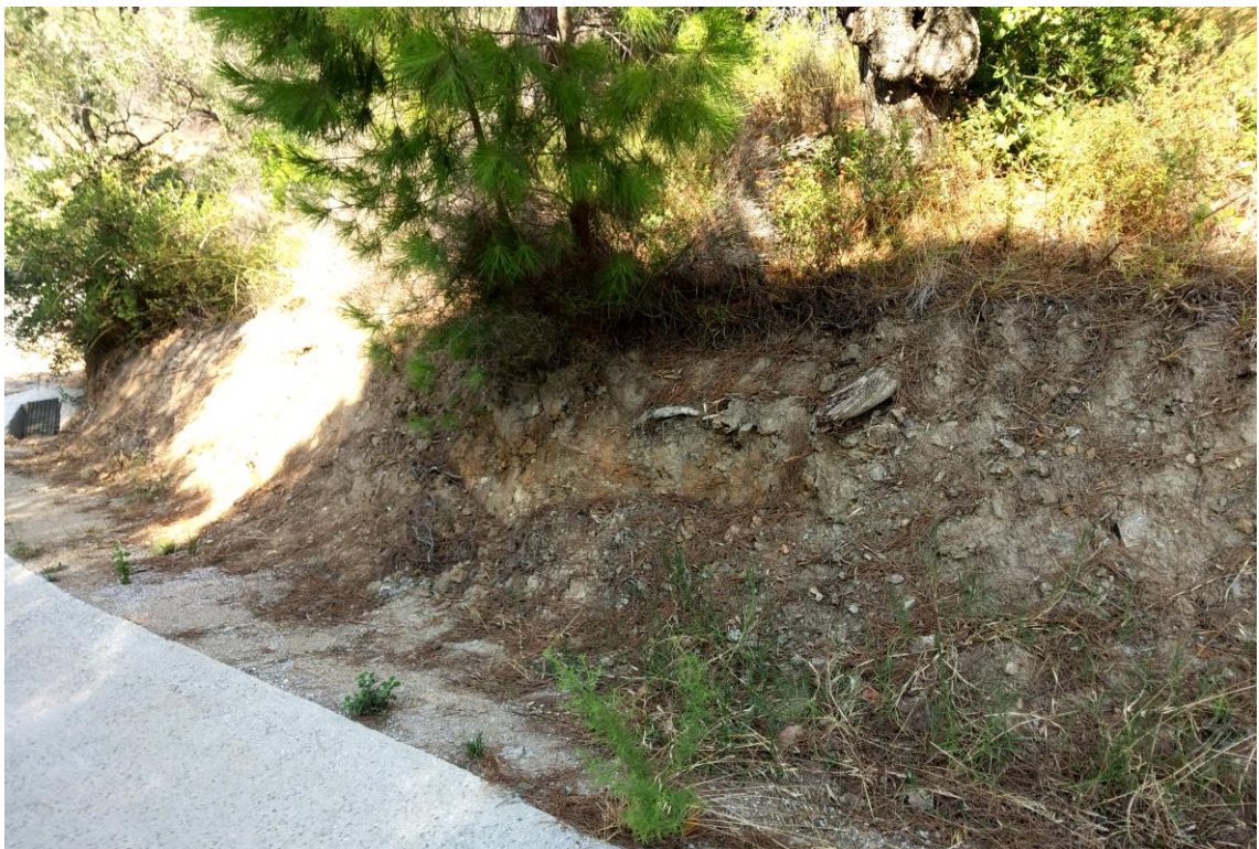
Φωτο Π.22: Βόρεια Έκταση. Άποψη της ισχυρά αποσαθρωμένης βραχομάζας γνευσιακής σύστασης, που εντοπίζεται στο κεντρικό τμήμα της εξεταζόμενης έκτασης.
