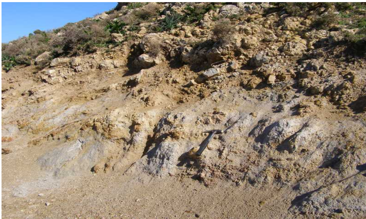
Φωτ. 17 – ΣΠ 20: Εμφάνιση λεπτοστρωματώδους μάργας με στρώση ομόρροπη προς την κλίση του πρανούς.
