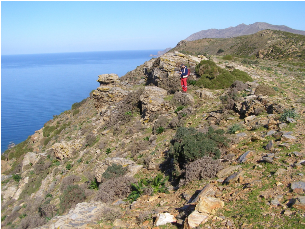
Φωτ. 10 – ΣΠ 11: Άποψη επικρεμάμενων έντονα μεταμορφωμένων φυλλιτών - χαλαζιτών. Άμεσος κίνδυνος εκδήλωσης βραχοπτώσεων (καμπτικές ανατροπές).
