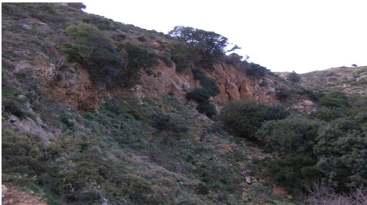
ΦΩΤ. 50 – ΣΠ 52: Αστοχίες πρανών και καταπτώσεις βράχων (ολισθόλιθοι – οι) μαργαϊκών ασβεστόλιθων.
