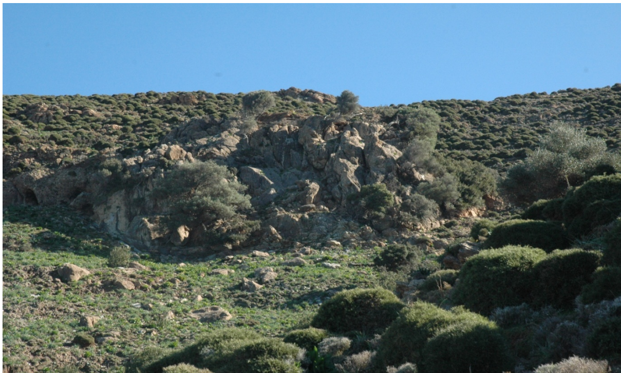
Φωτ. 68 – ΣΠ 66: Καταπτώσεις βράχων Μεταμορφωμένων Κροκαλοπαγών (Mm). Ανάγκη λήψης μέτρων προστασίας από βραχοπτώσεις.
