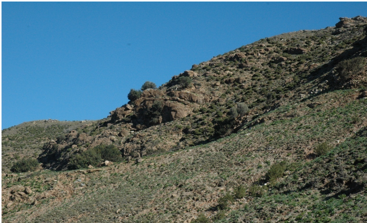
Φωτ. 69 – ΣΠ 66: Καταπτώσεις βράχων Μεταμορφωμένων Κροκαλοπαγών (Mm). Ανάγκη λήψης μέτρων προστασίας από βραχοπτώσεις
