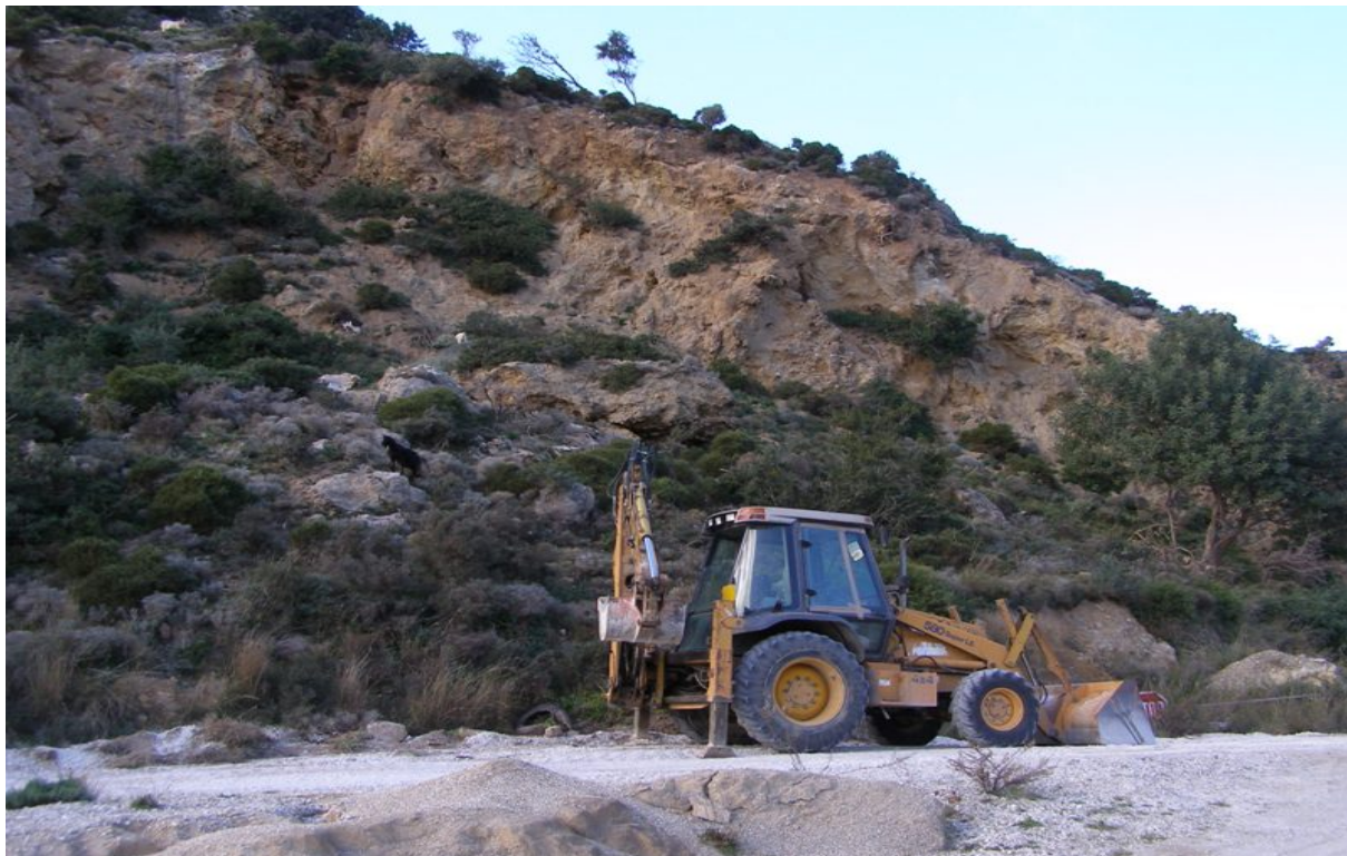
ΦΩΤ. 49 – ΣΠ 52: Αστοχίες πρανών και καταπτώσεις βράχων (ολισθόλιθοι – οι) μαργαϊκών ασβεστόλιθων.
